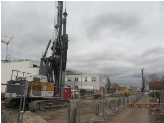
Im Westen (Alemannenstr.) werden nach den Leitungsverlegungen nun die Bohrarbeiten für den Baugrubenverbau durchgeführt
