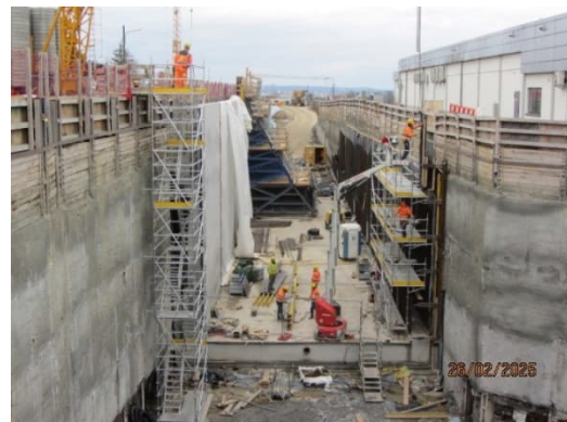
Der Betonbau in der Baugrube im Bereich südlich der Heubergstraße läuft auf Hochtouren.
